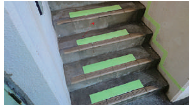
工場 屋外階段 スーパー夜光塗料LAG使用
