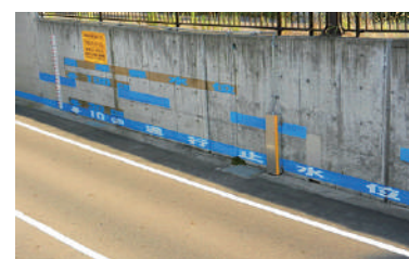
アンダーパス 水位表示 ビームライト#300使用
